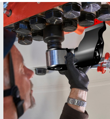
alkitronic® AT Einsatz in einer Windkraftanlage
